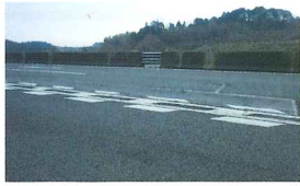
舗装損傷状況
