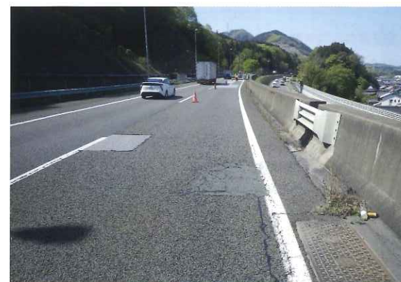
舗装損傷状況
