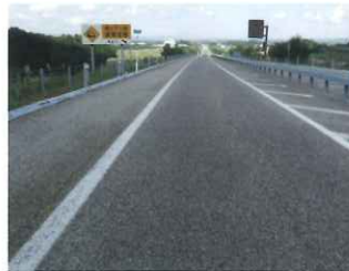
路面補修(施工前)
