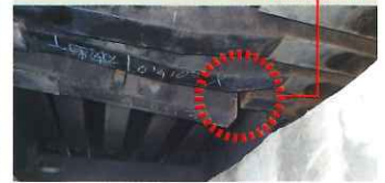
下面から見た伸縮装置の破断状況
