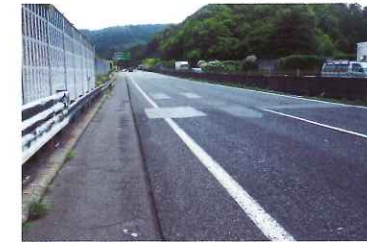
舗装損傷状況
